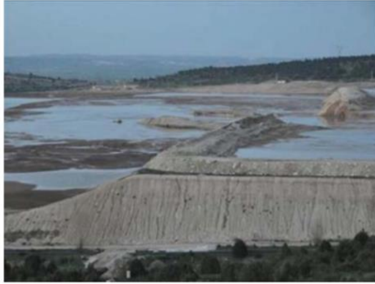
Şekil 3 - Eti Gümüş Atık Barajı Sedde Yıkılması
